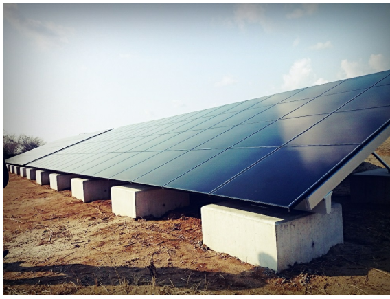
太陽光パネル
